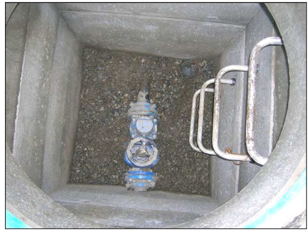
Photo 12 : Intérieur du regard abritant le compteur (Source : HYDRETTUES le 25 nov. 2011)
