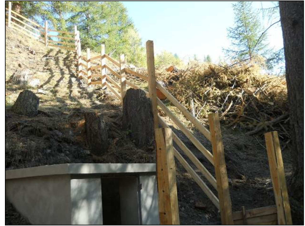
Photo 4 : Intérieur de l'édicule de captage – Mounal 2 (Source : HYDRETTUES le 6 oct. 2011)
