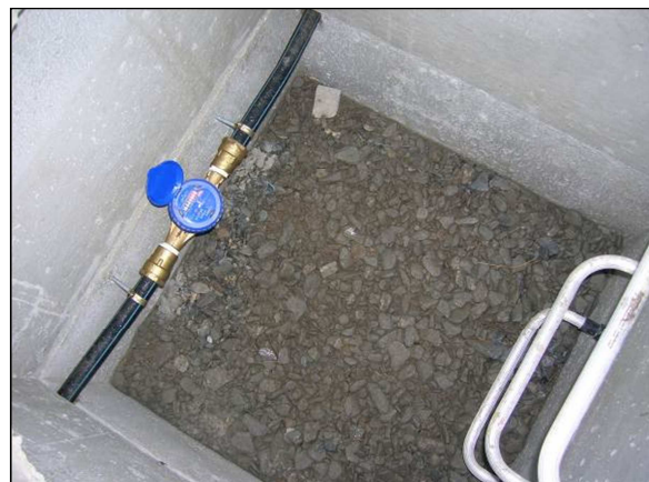
Photo 18 : Compteur de production du Varenc (Source : HYDRETTUES le 29 sept. 2011)
